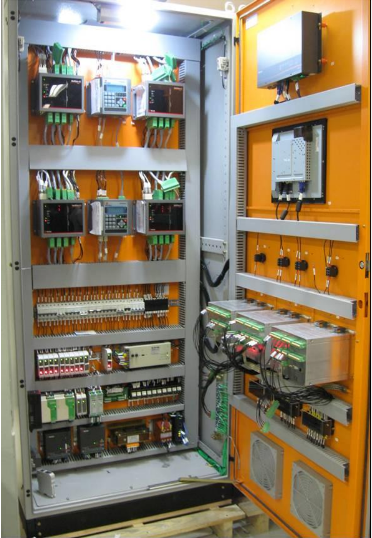
Figura 2 - Interior de um painel de controle
