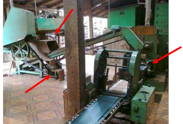
Fotografia 10: Partes móveis sem proteção e acessos improvisados
