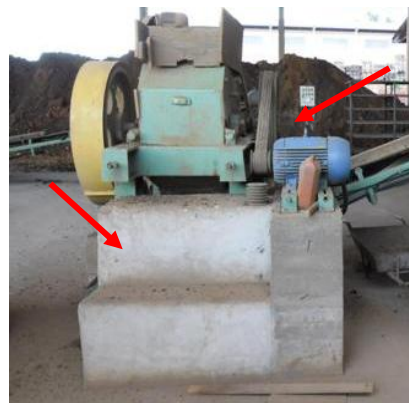
Fotografia 8: Partes móveis e acessos sem proteção
