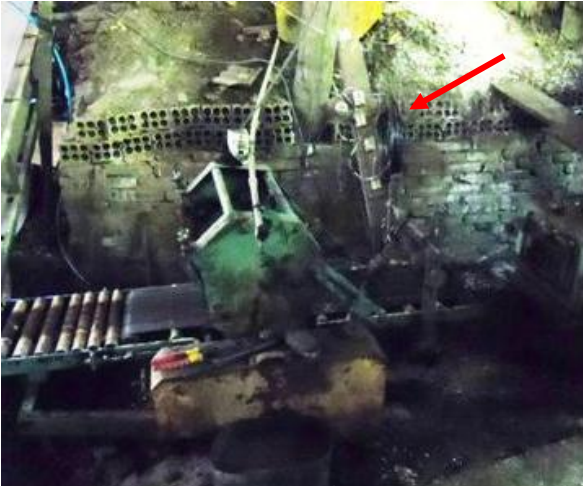
Fotografia 3: Instalação elétrica improvisada
