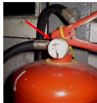
Fotografia 14: Extintor sem carga
