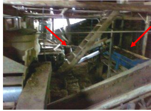
Fotografia 6: Máquina com partes móveis sem proteção e improvisações
