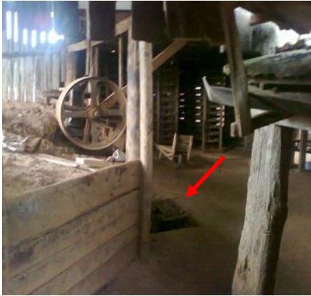
Fotografia 1: Piso irregular com aberturas desprotegidas em área de circulação
