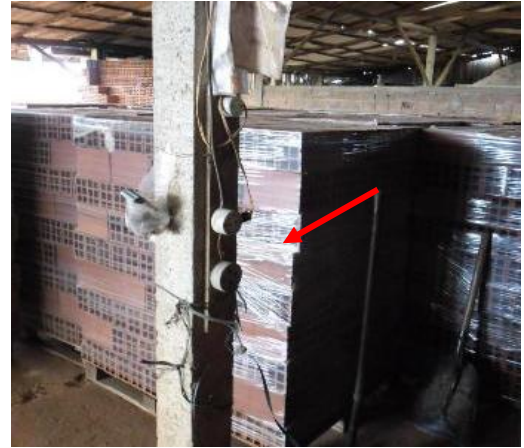
Fotografia 4: Instalação elétrica inadequada
