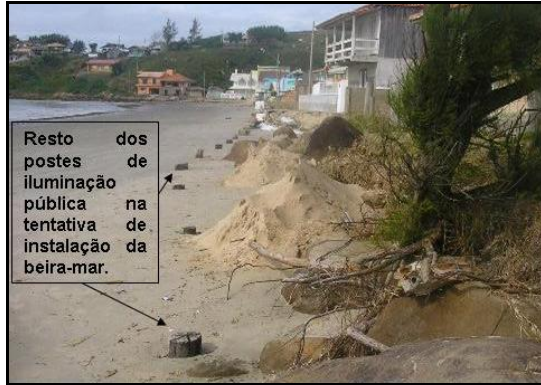
Figura 35. Imagem que demonstra os restos dos postes de iluminação que ainda são possíveis de se observar quando da tentativa de instalação de uma passarela beira-mar (Foto de Ana Fatima da Silva, novembro de 2008).
