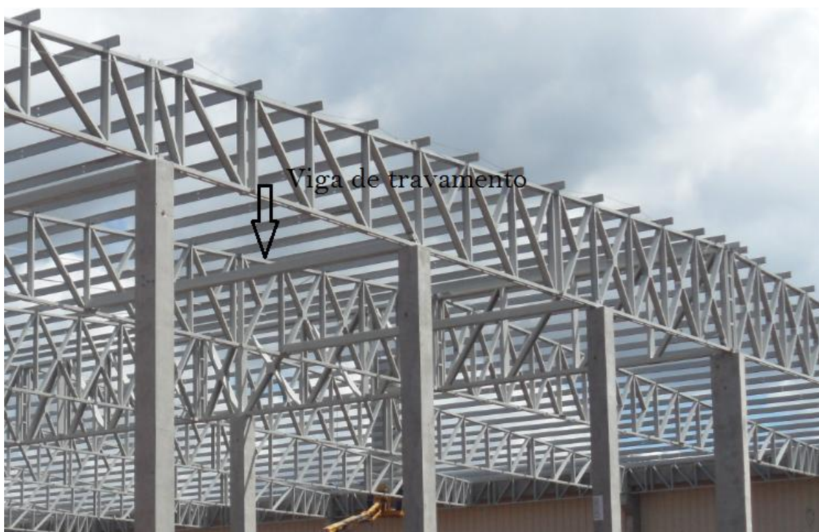
Figura 20 – Viga de travamento do banzo inferior da tesoura
