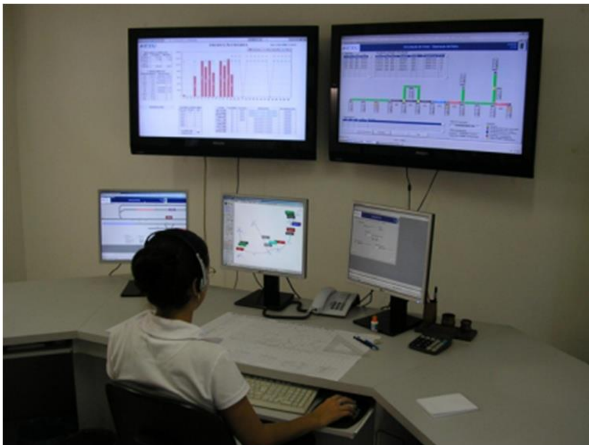
Figura 5 – Centro de Controle Operacional (CCO)
