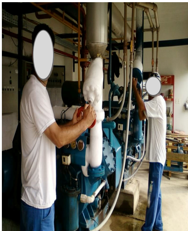
Figura 11 – Setor de Máquinas
