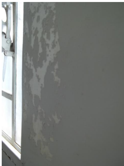
Fotografia 2: Parede permeável à umidade. Fonte: E. E. B. Presidente Artur da costa e Silva (2013)
