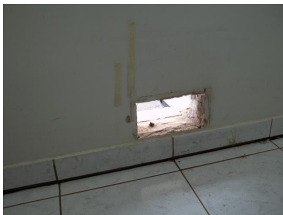
Fotografia 3: Abertura na parede desprovida de proteção. Fonte: E. E. B. Presidente Artur da costa e Silva (2013)
