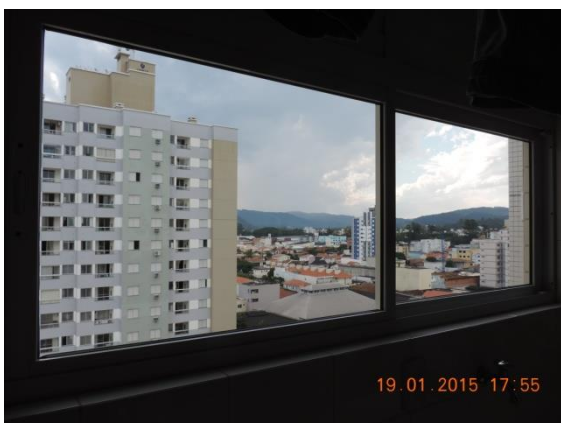
Figura 40 - Janelas sem proteção
