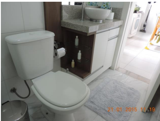
Figura 35 - Pia e vaso sanitário
