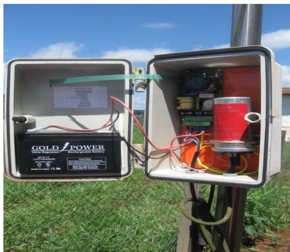
FIGURA 02: DEFEITO EM CAIXA DE FORÇA NA PROPRIEDADE
