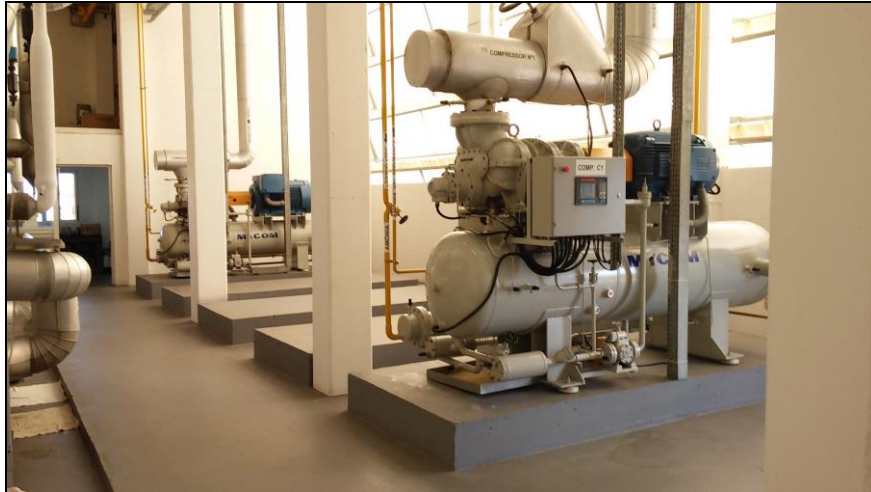
Figura 7 – Casa de máquinas da ITAZEM. Fonte: Arquivo pessoal
