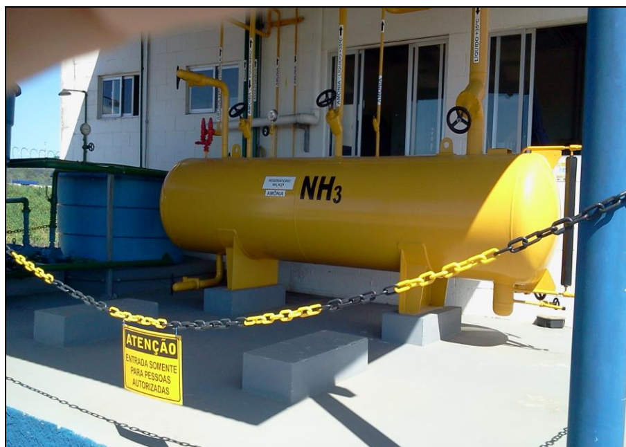
Figura 6 – Reservatório de amônia localizado na área externa do prédio Fonte: Arquivo pessoal
