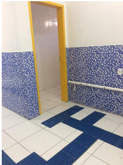
Figura 6 - pisos podotáteis no acesso ao banheiro feminino
